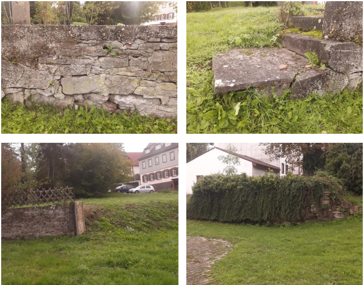
Abbildung 5: Artenschutzrelevante Strukturen: Mauer (oben links), Betontreppe (oben rechts) und Böschung (unten links) im Südwesten des Planungsgebiet; mit Efeu überwachsene Mauer südlich des Doppelwohnhauses (unten rechts).
